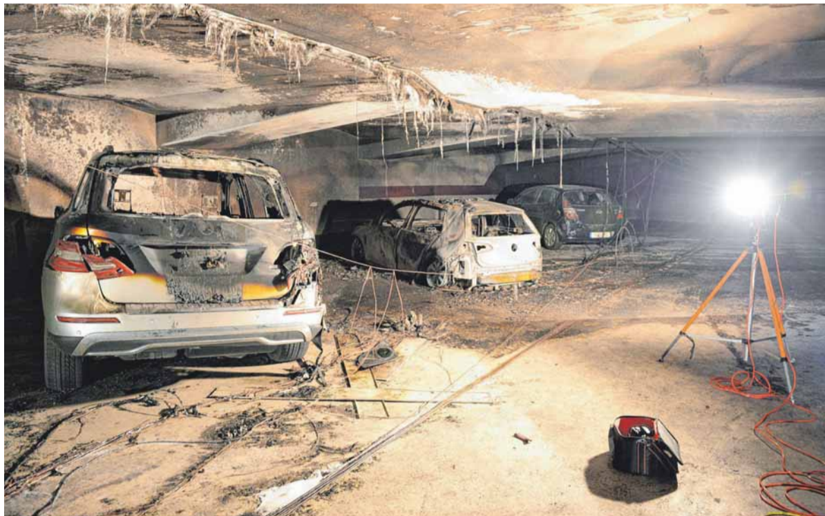
Im September 2014 brannte es in der Ravensburger Marienplatz Tiefgarage. In der Folge wurden massive Tausaltschäden an den Stahlbetonbauteilen entdeckt, die Garage muss seither aufwendig saniert werden. Nach der Wiedereröffnung soll es dort auch Tankstellen für E-Fahrzeuge geben. ARCHIVFOTO: FELIX KÄSTLE
