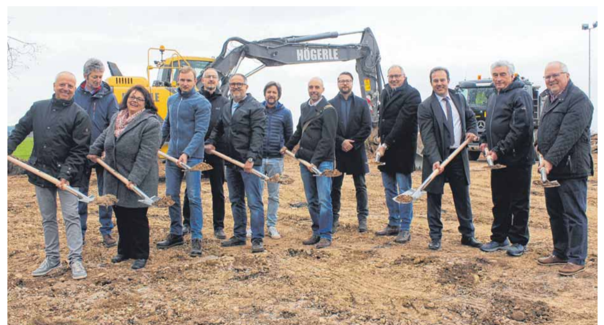
Ein Projekt mit vielen Beteiligten: Nach der langen Vorbereitungszeit kamen zum Spatenstich nicht nur Vertreter der Gemeinde und der Baufirmen, sondern auch der Vereine aus Haslach, des Ortschafts- und Gemeinderats und andere.
