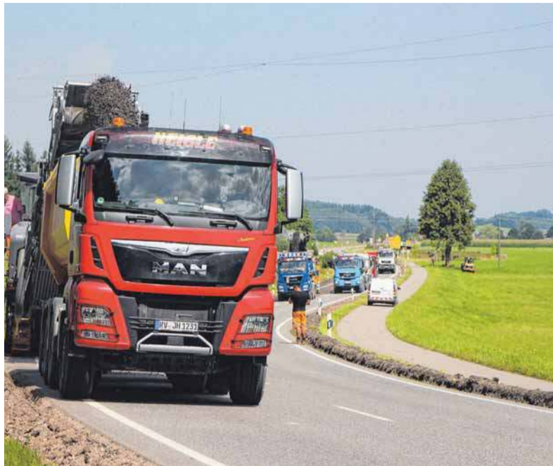
Im vergangenen Jahr wurde der Fahrbahnbelag der B 465 zwischen Brugg und Diepoldshofen erneuert.
