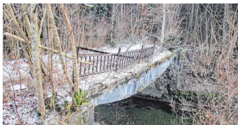
Dieses Foto von der maroden Brücke in Eglöfstal haben die Gutachter vor Weihnachten gemacht. FOTO: LANDRATSAMT
